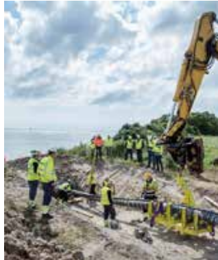
Varmaefledning af højspændingskabler
