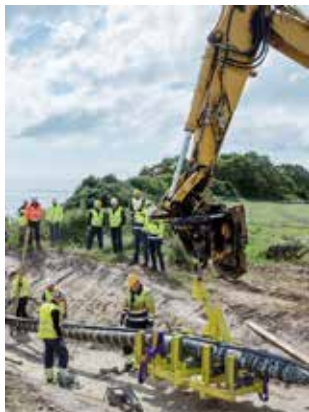
Varmeafledning af højspændingskabler
